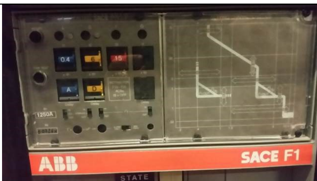
Interruttore a carrello a servizio del sistema di commutazione rete normale/preferenziale - unità di protezione
