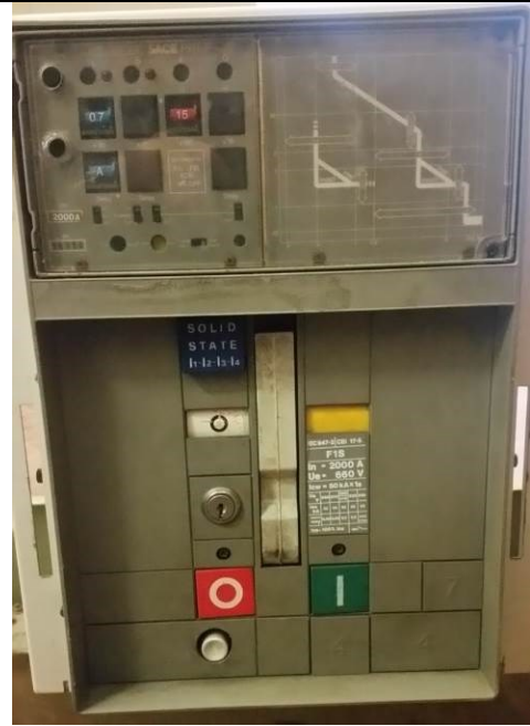
Interruttore a carrello a servizio del rifasatore automatico
