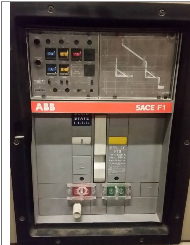
Interruttore a carrello a servizio del sistema di commutazione rete normale/preferenziale
