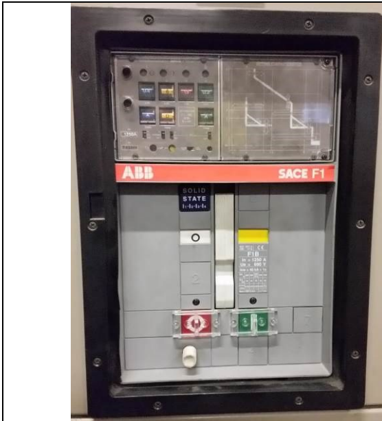
Interruttore a carrello a servizio del sistema di commutazione rete preferenziale/gruppo elettrogeno
