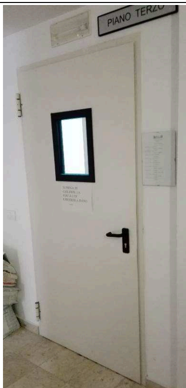
Porta REI 120 al piano terzo lato scala
