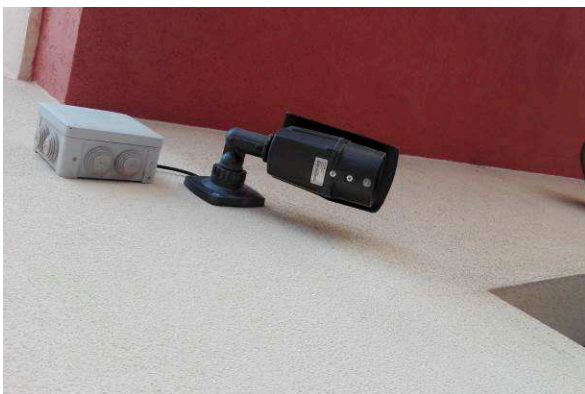
telecamera dell'impianto di videosorveglianza ubicata sopra l'ingresso contribuenti
