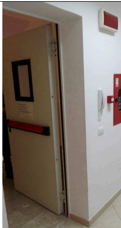
Porta REI 120 al piano terzo lato corridoio
