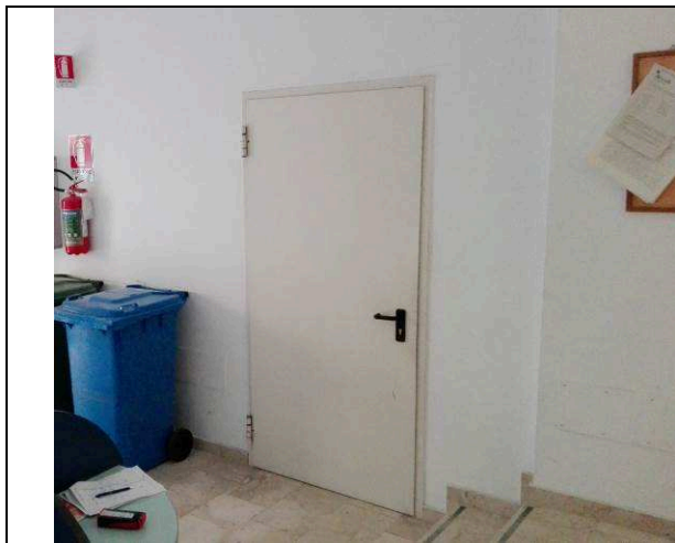
Porta REI 120 al piano terra lato scala
