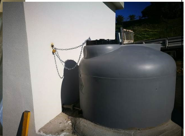
Nuovo serbatoio per lo stoccaggio dell'ipoclorito
