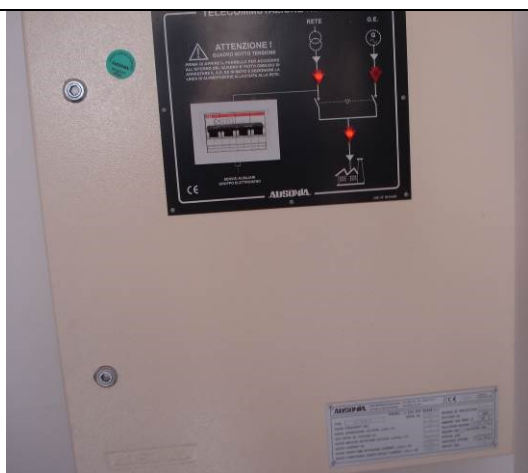
Quadro di commutazione rete gruppo
