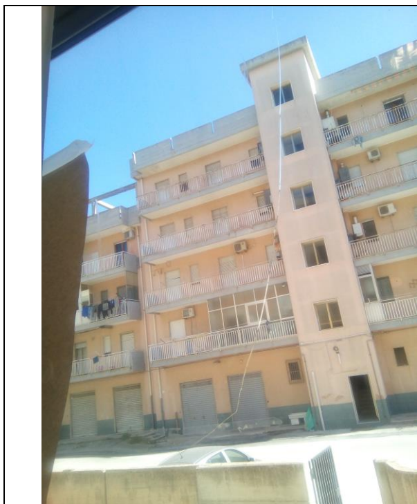
Lesioni sulla superficie vetrata
