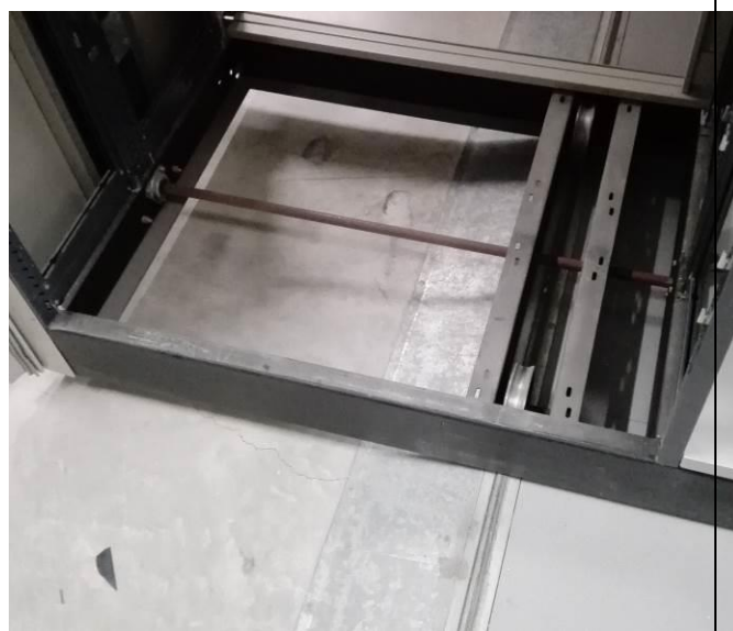
Particolare binario di scorrimento in prossimità del meccanismo di movimentazione
