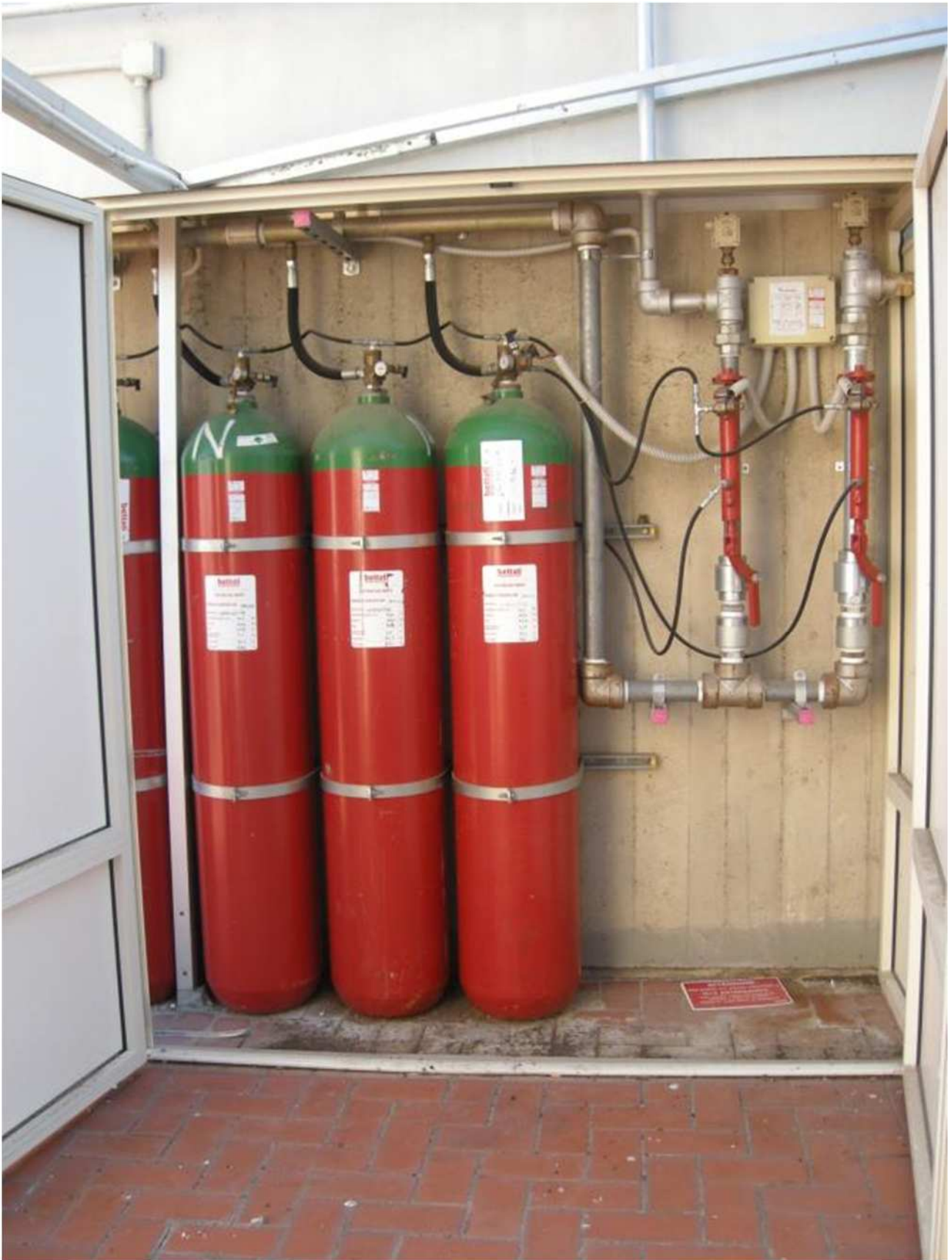
Foto n. 4 – gruppo bombole e sistema di comando
