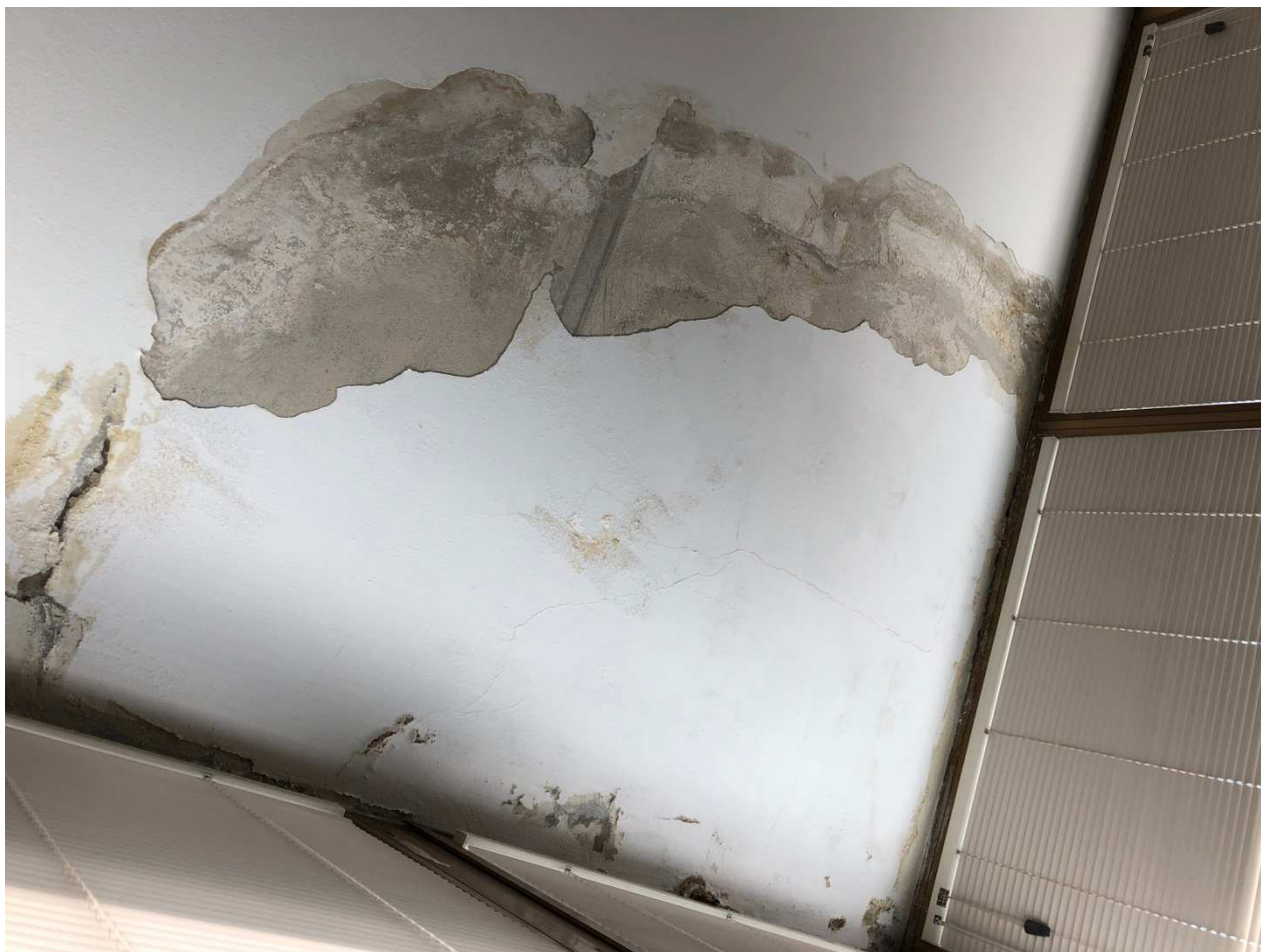
foto 17 erosione dell'intonaco nella stanza 1.4 bis a piano primo
